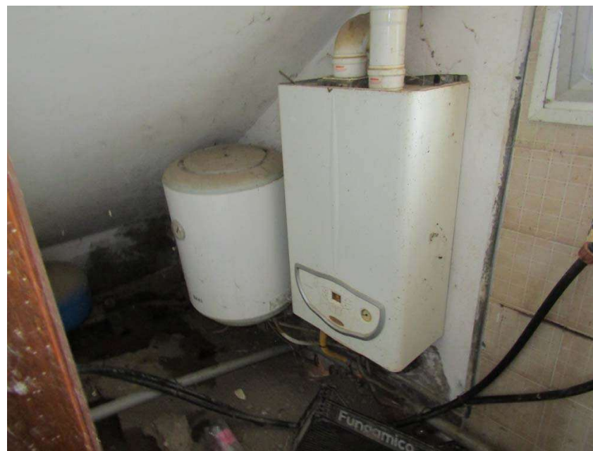
Foto 18: vista del sottoscala con la caldaia
